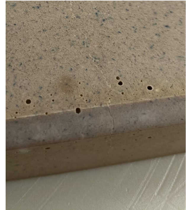
Levyyn ilmestynyt halkeama
